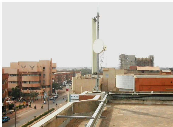
Installation de téléphonie mobile (Celtel-Burkina)
